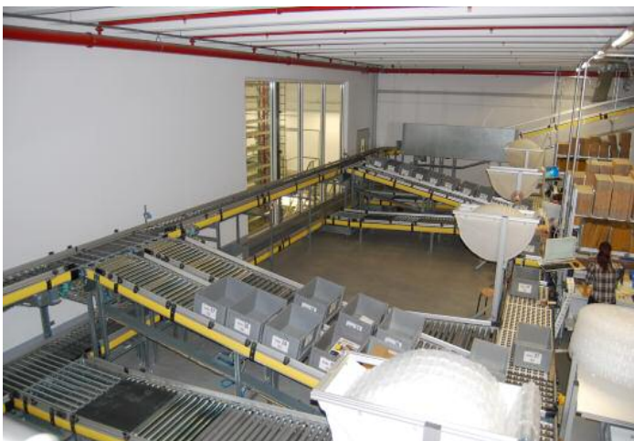
Über eine automatische Förderanlage werden die Behälter durch PSI wms zum Versandbereich gesteuert
